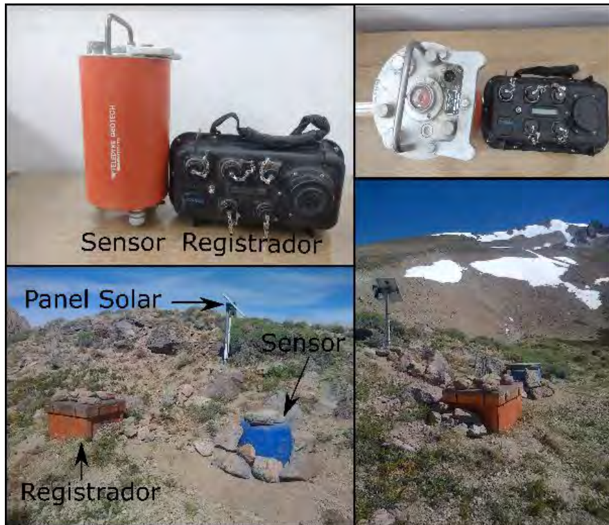
Figura III-II. Fotografías (en perfil y planta) de los sensores y registradores utilizados en la red local Domuyo 2015-2016. Las dos fotografías inferiores muestran la instalación de dos estaciones sismológicas.
