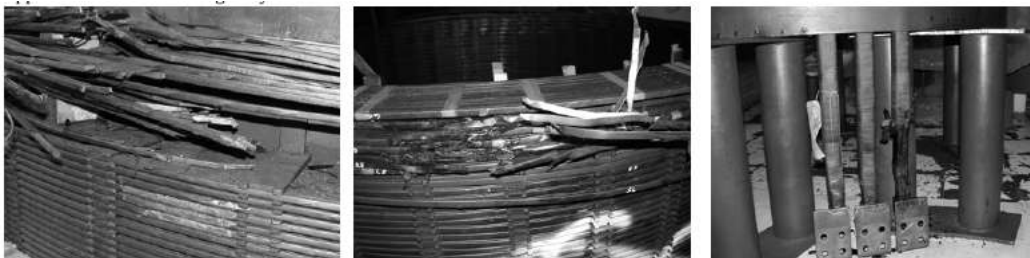
Figura 1.1: Daños causados por CIG en transformadores de alta tensión de la red eléctrica de Sudáfrica 2003. (Gaunt and Coetzee, 2007)
