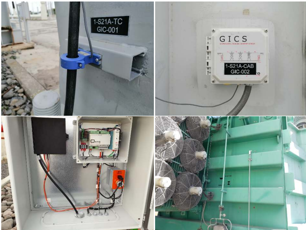
Figura 3.8: Sensores de CIG instalados en las subestaciones de Laguna Verde (arriba) y Querétaro Potencia (debajo). (izq. arriba) Sensor Hall adherido al neutro común del banco de transformadores (cabo negro). Caja con la electrónica de control (der. arriba). Unidad de comunicaciones y datalogger (izq. abajo). Sensor de temperatura (der. abajo)
