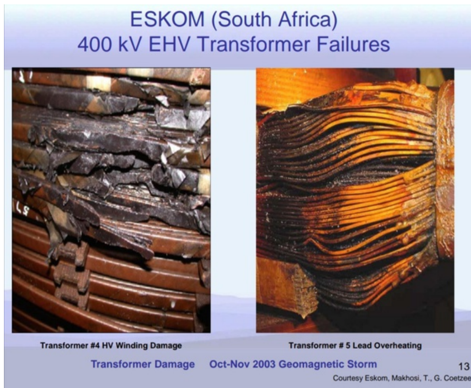
Figura 2.9: Bobinados dañados en transformadores de ESKOM en Sudáfrica. Este deterioro fue causado por CIGs no superiores a 10 A fluyendo por algunas horas durante las Tormentas de Halloween, Octubre - Noviembre 2003 (Gaunt and Coetzee, 2007)
