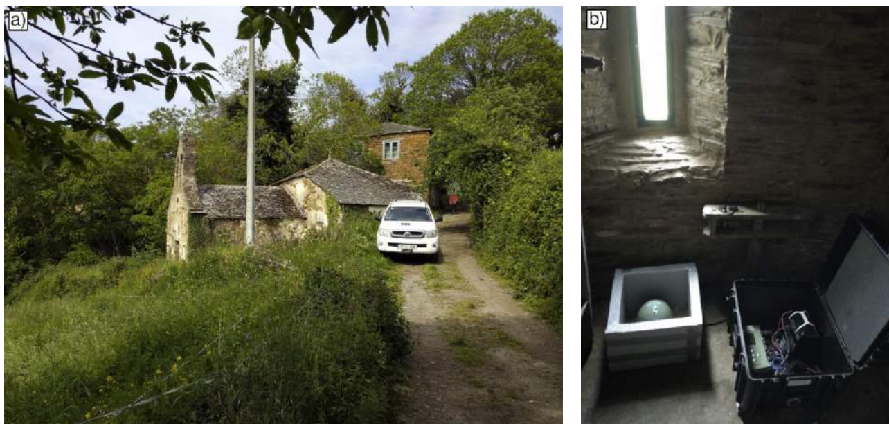
Figura 4. 6. Ejemplo de estación sísmica de la red GEOCSN instalada en una edificación. (a) Vista exterior de la capilla en la que se emplazó la estación sísmica SUAR (Virigo, Navia de Suarna, Lugo). (b) Estación SUAR, mostrando el geófono Trillium 120 PA (caja blanca), el digitalizador y la batería de 12V (caja negra).
